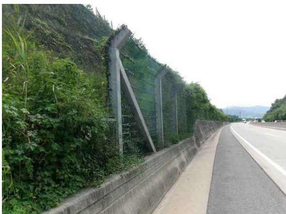
도로부 낙석방지울타리 전경
