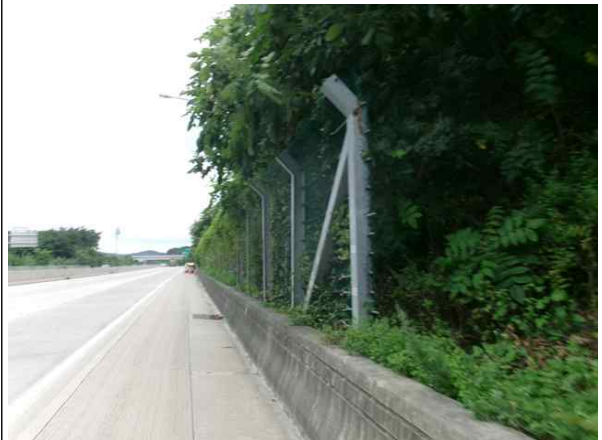
낙석방지울타리, 도로부 전경
