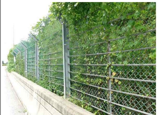
도로부, 낙석방지울타리 전경
