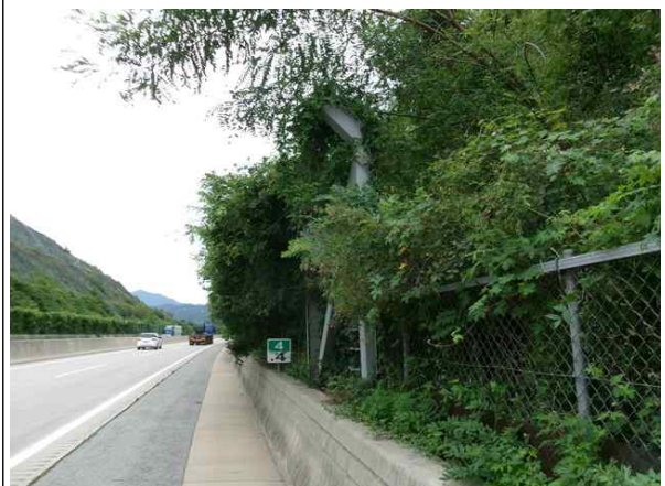
도로부, 낙석방지울타리 전경
